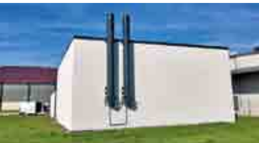
Chaufferie de Saint-Pierre-le-Moûtier
