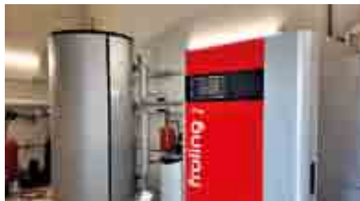
Chaufferie de Sougy-sur-Loire
